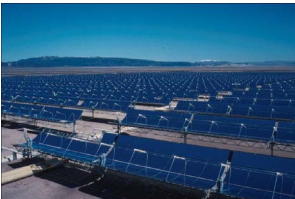
Solarthermische Kraftwerke nutzen Spiegel, um Sonnenlicht zu bündeln und damit Dampfturbinen anzutreiben. Sie können durch thermische Speicher Tag und Nacht Strom produzieren.
